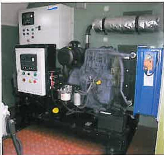
Autonomiczny agregat zasilający umieszczony w przedziale technicznym kabiny dowodzenia.
