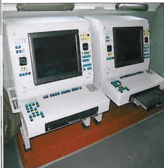
Zautomatyzowane stanowiska robocze ARM-1 i ARM-2 w kabine dowodzenia.
